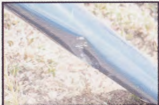
Fotografía No. 21 Daños en el cargador transversal
